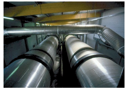
»Große Technik« im Humuswerk Essenheim: Zwei Rottetrommeln mit jeweils 23 Metern Länge und einem Fassungsvermögen von 450 Kubikmetern
