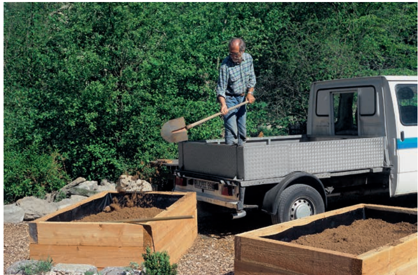
„Auf das Drainage-Vlies wird das Substrat (hier eine Mischung aus Sand und Kompost) geschaufelt.“ (Bildrechte: Brigitte Kleinod)
